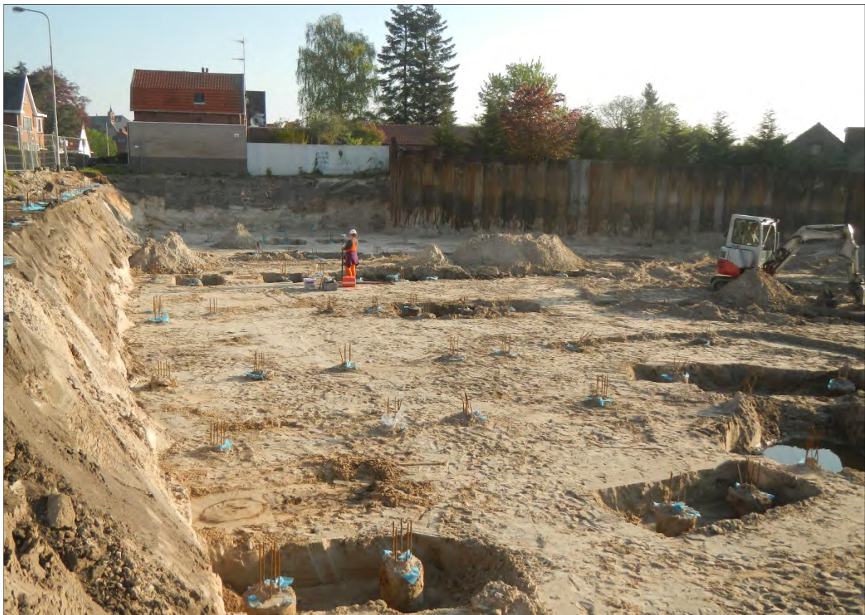
Afbeelding 6 Overzicht werkput na uitvoering van fase 2 – ontgraving tot onderzijde kelderniveau. Foto genomen richting het noorden.
